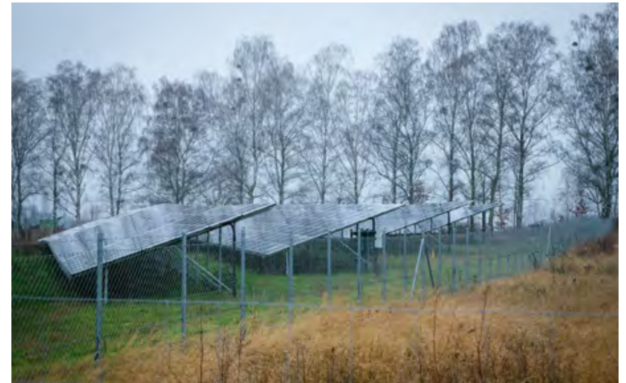
Photovoltaikanlage auf Freifläche zwischen Kröchlendorff und Beenz
